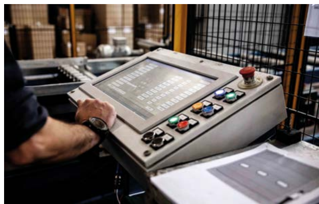
Sistema di controllo automatizzato. Automated control system.
